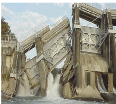
Рис. 4. Разрушение плотины Ши-Кань на Тайване во время землетрясения Чи-Чи 21.09.1999 г. [1, 2]
