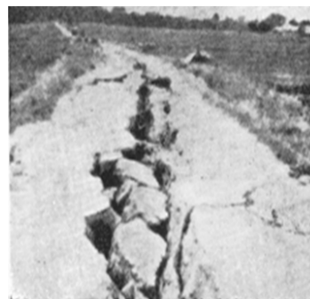
Рис. 3. Поднятие дна канала вследствие землетрясения
